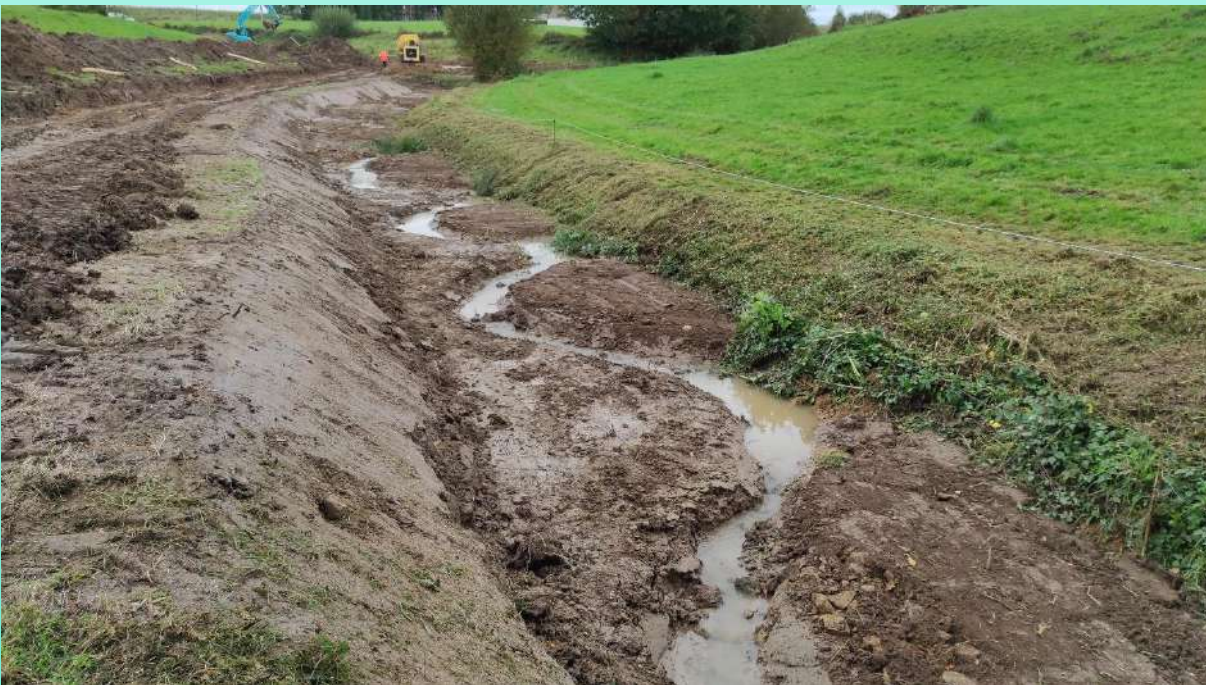
Après travaux : ruisseau présentant des méandres et pouvant déborder, des granulats ont été ajoutés pour recréer le fond naturel du ruisseau
